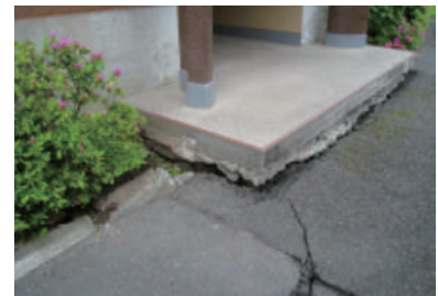
〈地盤が沈下し、液状化が発生〉
