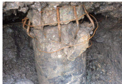
〈損傷した杭の様子〉
